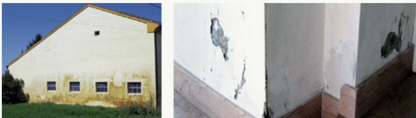
Figura 1 - Esempi umidità di risalita
