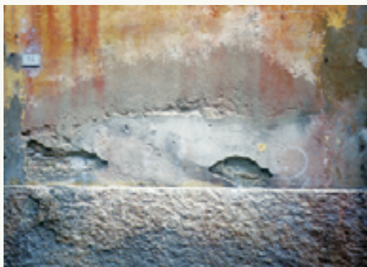
Figura 8 - Fenomeno dovuto al gelo
