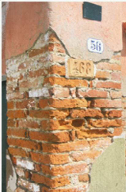
Figura 7 - Fenomeno dovuto a reazioni chimiche
