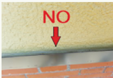
Figura 32 - Errata sigillatura della fuga tra cappotto e profilo di chiusura
