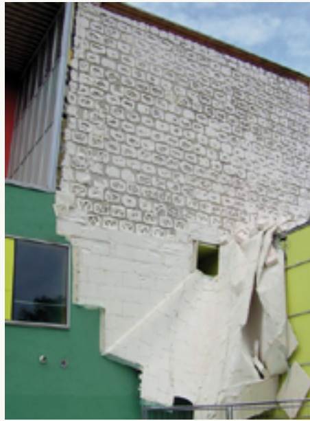
Figura 33 - Danni dovuti ad assenza di tassellatura
