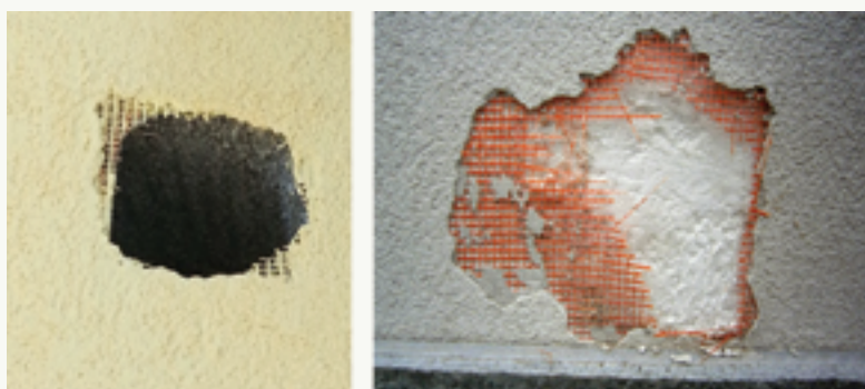
Figura 27 - Esempi di errato incollaggio della rete
