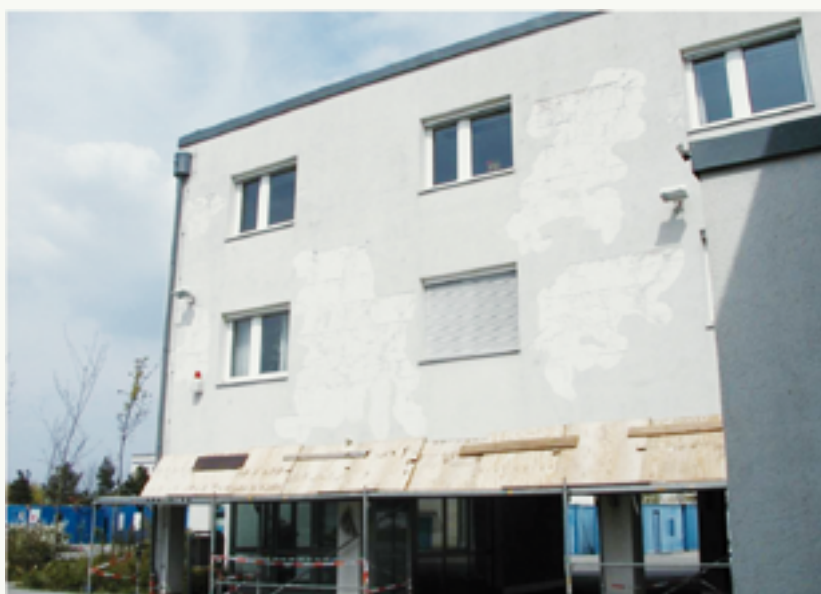
Distacco del rasante
